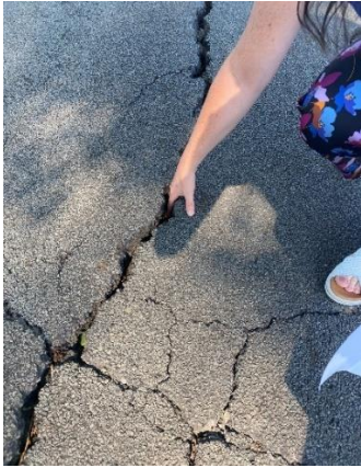
Figuur 14: Voorbeeld van een scheur ten gevolge van verdroging van de ondergrond in Maldegem
